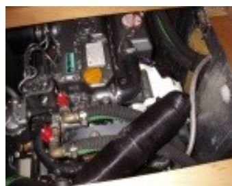
Friskluftindtaget er via den store rørforbindelse i forgrunden ledt direkte til generatoren for at forbedre kølingen
