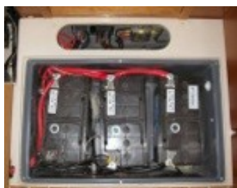
Troldands forbrugs-batterier med 3x 110 Ah/12 volt AGM batterier der er parallelt forbundne
