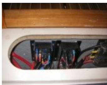
Generatorens elektro-niske 3 trins lade-regulator (tv) og det elek-troniske skillerælæ (th)
