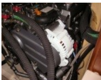
Eftermonteret 100Ah Balmar generator med 3 trins lade-regulator og temperatur sensor
