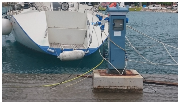
Oversvømmet kaj, stander med utætheder og et enkelt stik der virker... og det er der flere der har glæde af
